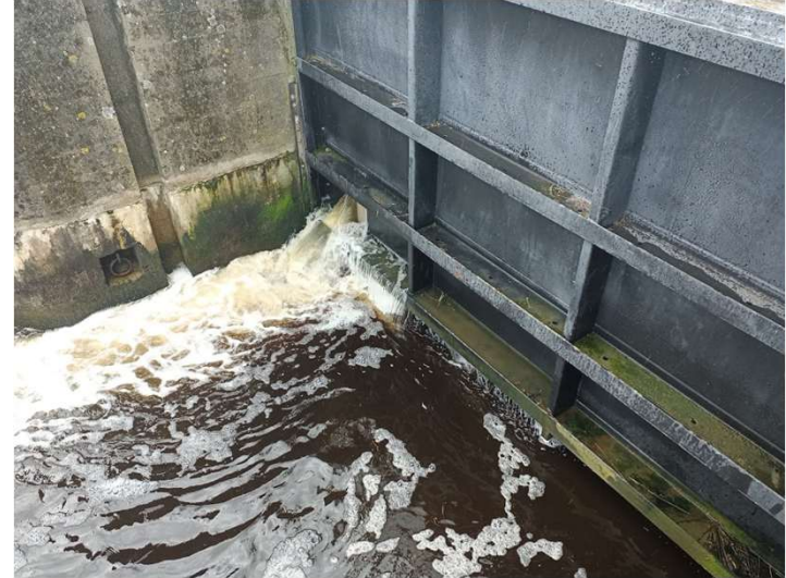
Fente piscicole haute de la vanne rive gauche de Méan
